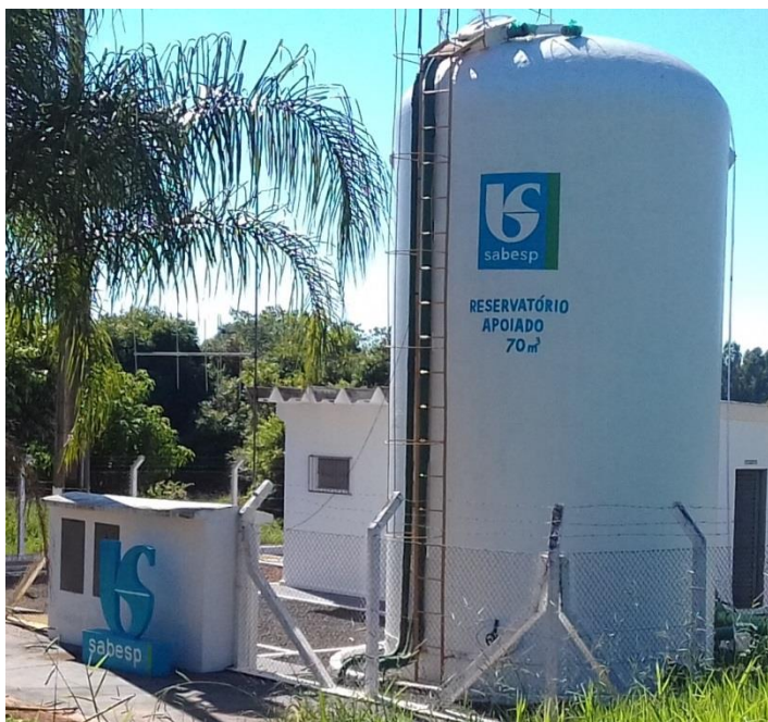
Foto 3.7 – Área dos Reservatório 1
