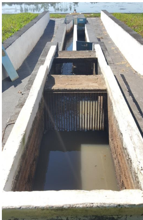
Foto 3.10 Gradeamento— Entrada ETE
