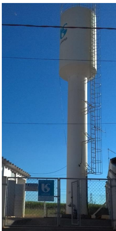
Foto 3.9 – Área dos Reservatórios 3
