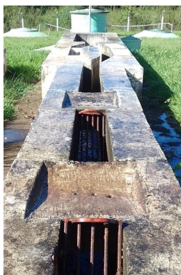
Foto 3.14 Gradeamento-- Entrada ETE
