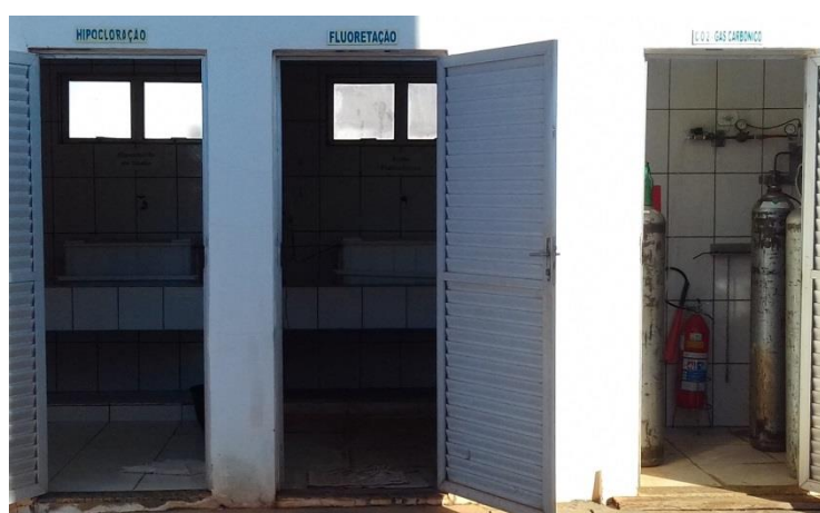
Foto 3.6 – Unidades de Fluoretação, Cloração e adição de CO 2 com bomba dosadora.
