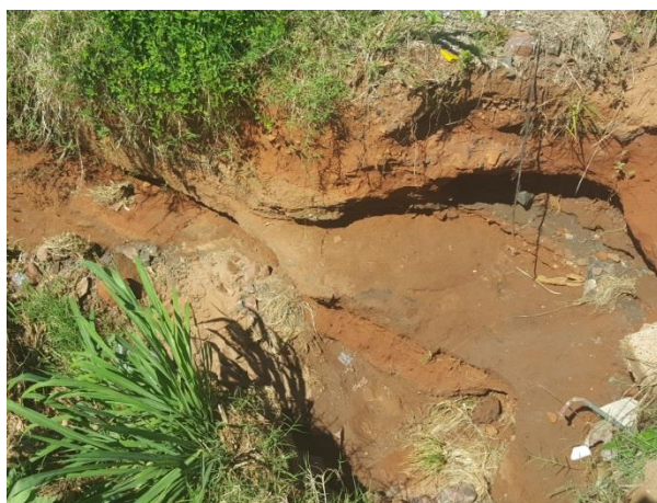
Foto 3.19 – Processo erosivo na rua Euclides com Tabão Tobita
