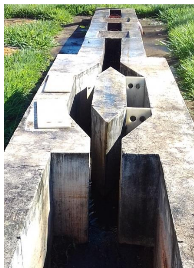
Foto 3.15 - Caixa de Areia – Entrada ETE
