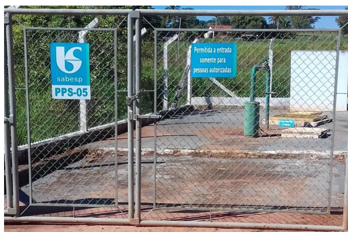
Foto 3.3 - Identificação do Poço: PPS-05
