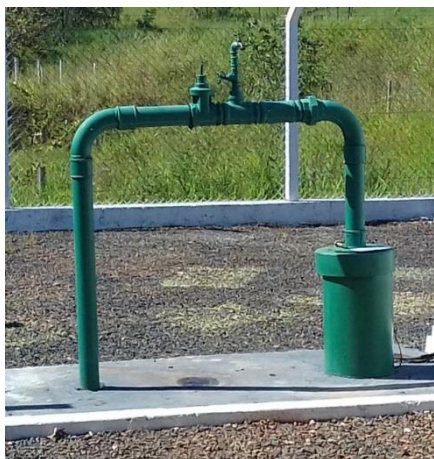
Foto 3.1 - Identificação do Poço: PPS-01
