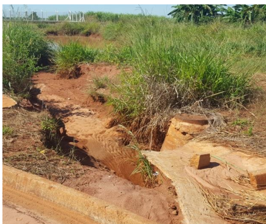
Foto 3.21 – Processo erosivo no loteamento Barreto
